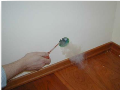
Luftundichtheit an einer Steckdose.
