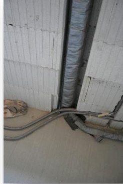
Abwasserleitung mit Schallschutz
