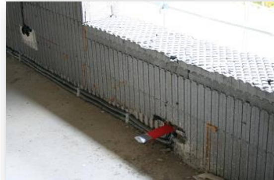
Heizungsanschluss unter dem Fenster
