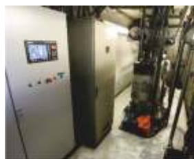
Unser BHKW zur Prozessdampferzeugung aus Biogas.
